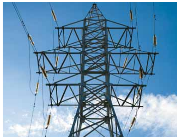
Tenersi a distanza di sicurezza dalle linee di alta tensione
